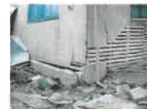
▲基礎と上屋の結合ができておらず 30cm 移動している様子
